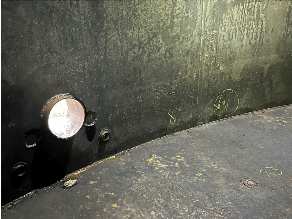
Mynd 5. Kverk geymis lítur vel út.
