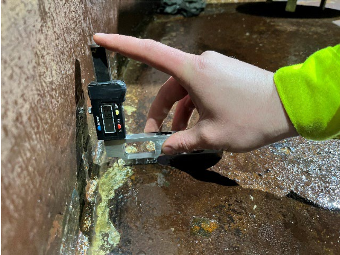
Mynd 8. Tæring við kverk geymis er 1.63mm djúp. Efnisþykkt gólfplötu er þar ss um 4,3mm
