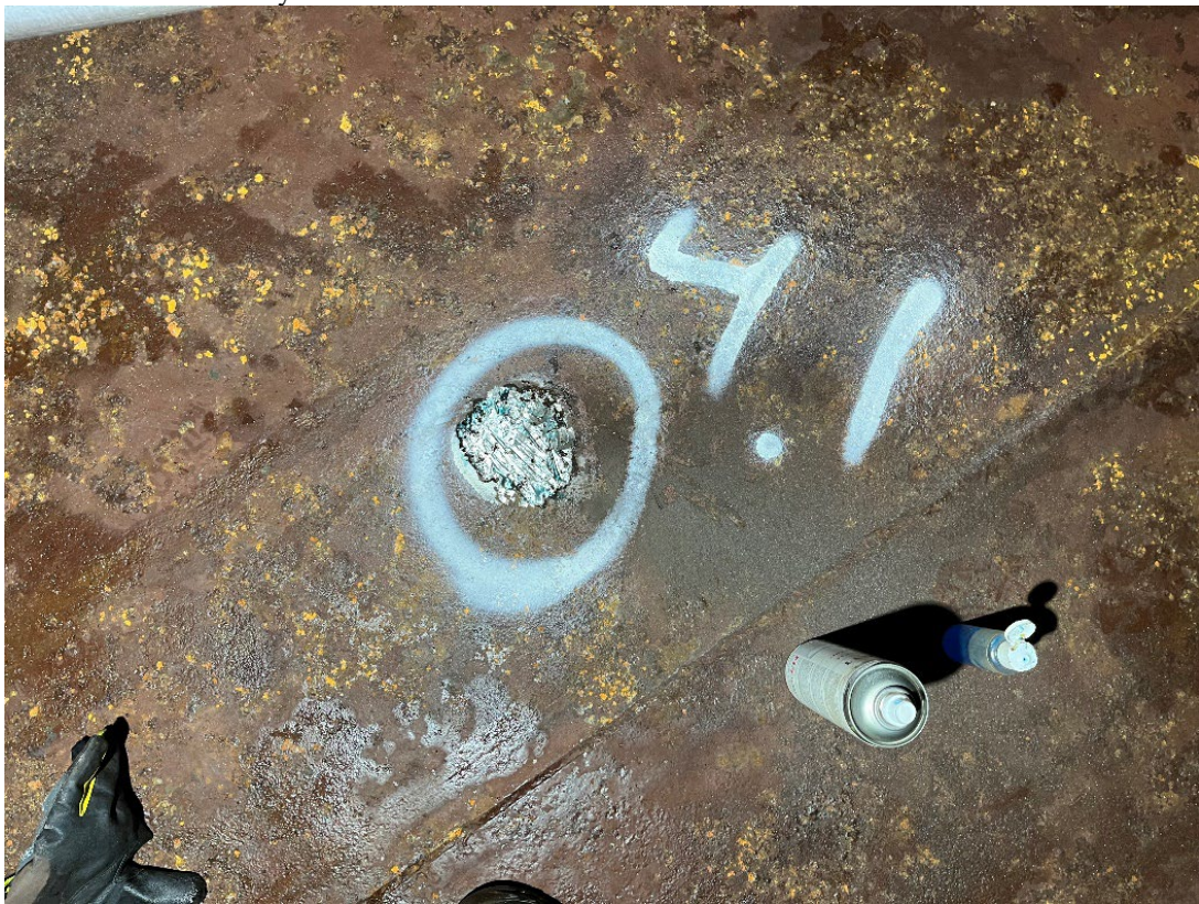
Mynd 3. Við segulskönnun fundust svæði sem gáfu tilkynna efnisþynningu á gólfi geymis. Allir staðirnir voru vel yfir viðmiðunarmörkum.
