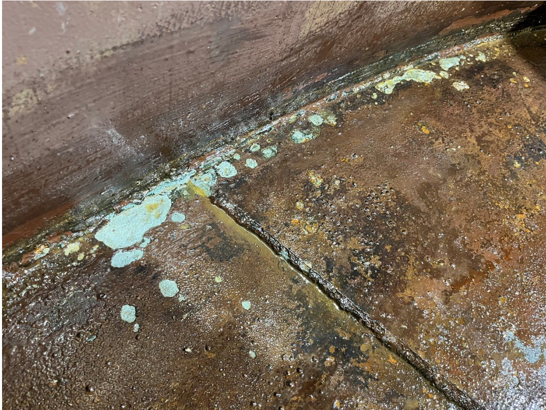
Mynd 4. Tæring við kverk geymis.
