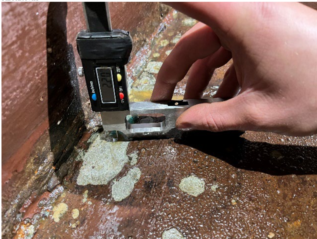
Mynd 6. Tæring við kverk geymis er 1.66mm djúp. Efnisþykkt gólfplötu er þar ss um 3,8mm
