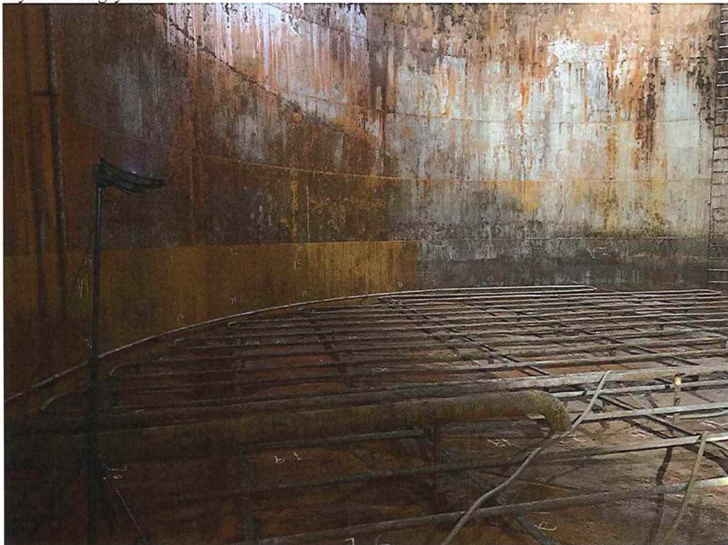
Mynd 2. Gólf og neðsta umfar er ómálað en án tæringar þótt ryðslykju megi sjá yfir allan geymirinn.
