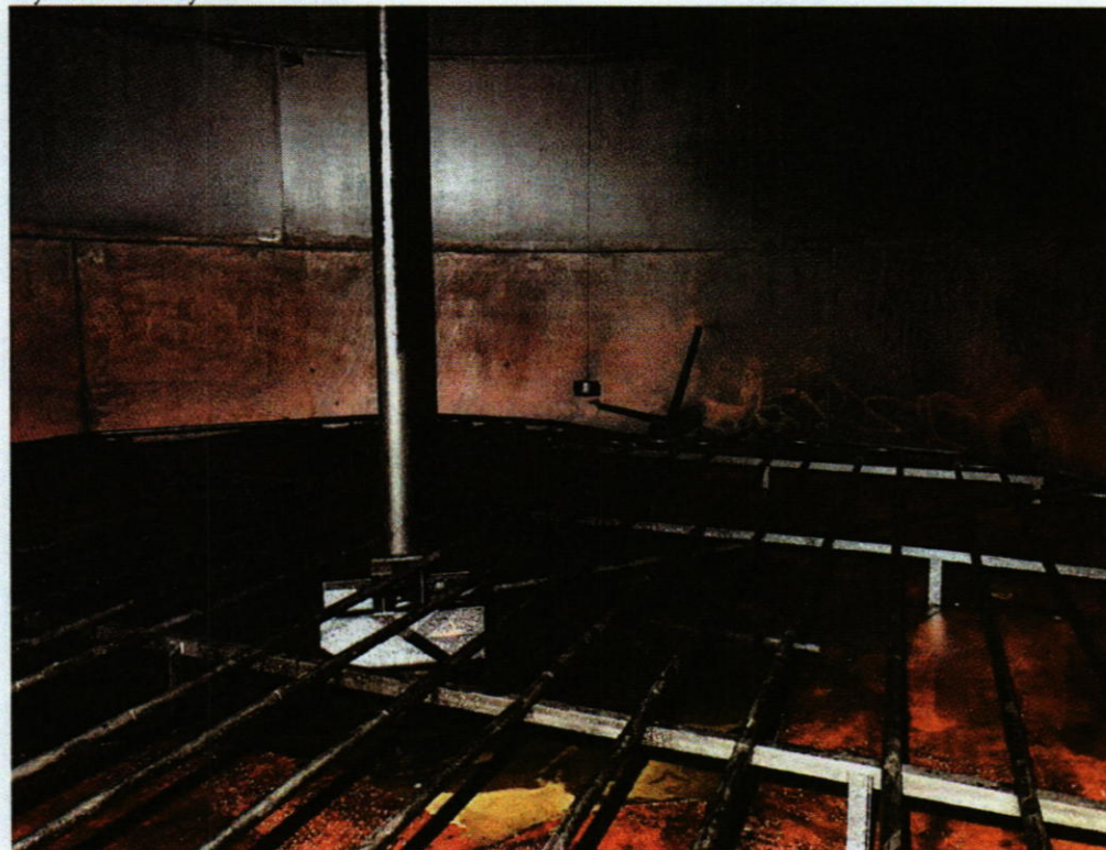
Mynd 2. Geymir er ómálaður að innan.
